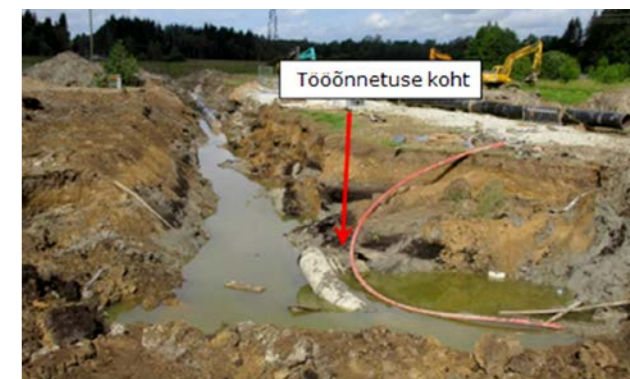
Õnnetuskoha esimene külastus. 2.07.2019 Puuduvad kaevandi sein varisemist takistavad tugielemendid ning abinõud, mis kaitsevad põhjas töötavaid inimesi kaevandi varisemise korral. Nõlva kalded ei maanda pinnase varisemisest tulenevat ohtu, kuna ei ole arvestatud pinnase tüübi, selle niiskusesisalduse, masinatest tuleva raskusjõu ja nende tekitatud vibratsioonist pinnasele.
