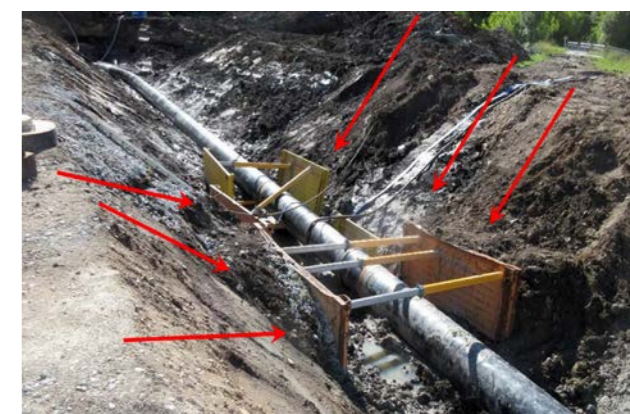
Õnnetuskoha teine külastus. 5.07.2019 Paigaldatud tugiseinte kõrgus ei ole piisav, et tagada pinnase varisemise korral kaevandis töötavate inimeste ohutust. Nõlva kalded ei maanda pinnase varisemisest tulenevat ohtu, kuna ei ole arvestatud pinnase tüübi, selle niiskusesisalduse, masinatest tuleva raskusjõu ja nende tekitatud vibratsioonist pinnasele. Kahel tugiseinal puuduvad nõuetekohased põikitoed.
